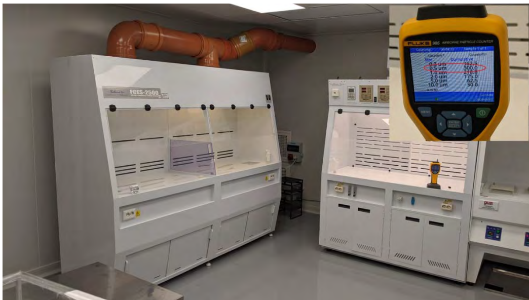
Zona de chimie, amenajata in 2020 cu hote pentru spălări chimice și corodări umede.
